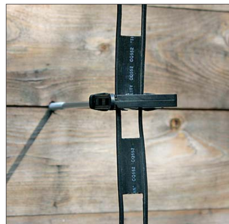
Bild 3: Leitungsführung an einer Holzwand
